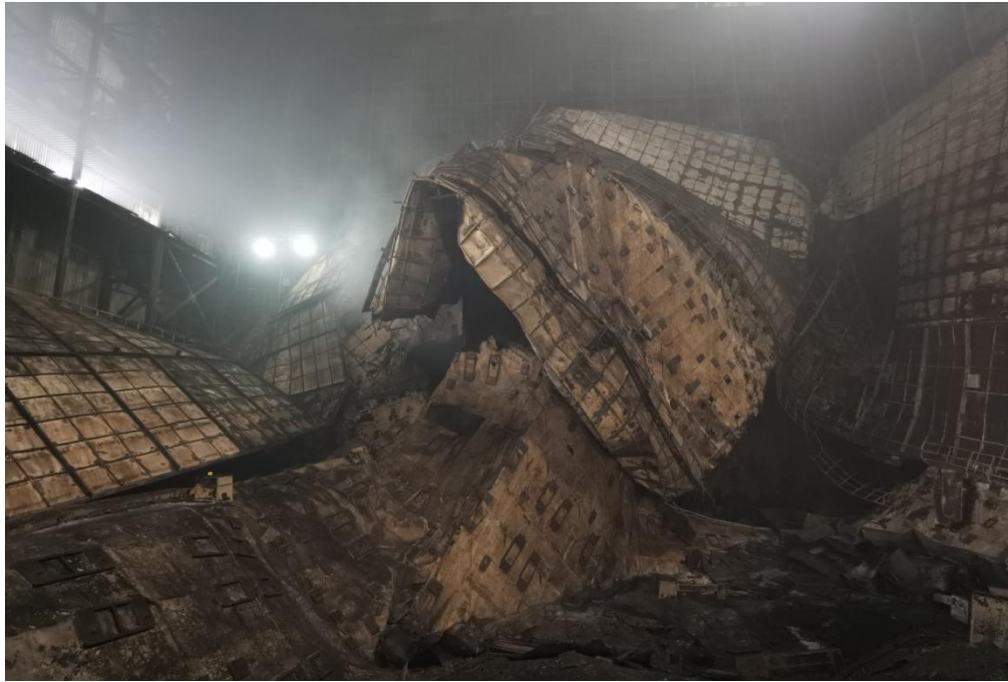
图二（暗室屏蔽钢结构坍塌现场）
