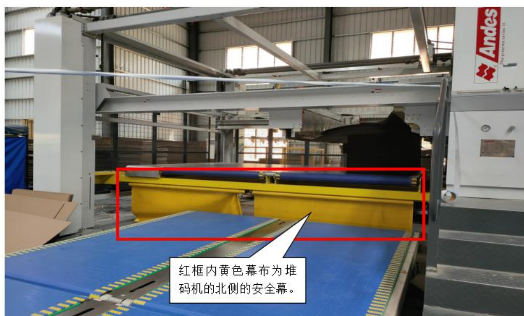
图 2：堆码机安全措施
