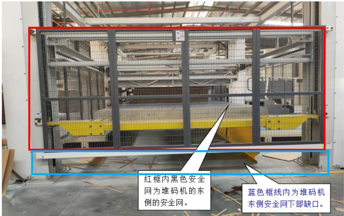
图 3：堆码机安全措施
