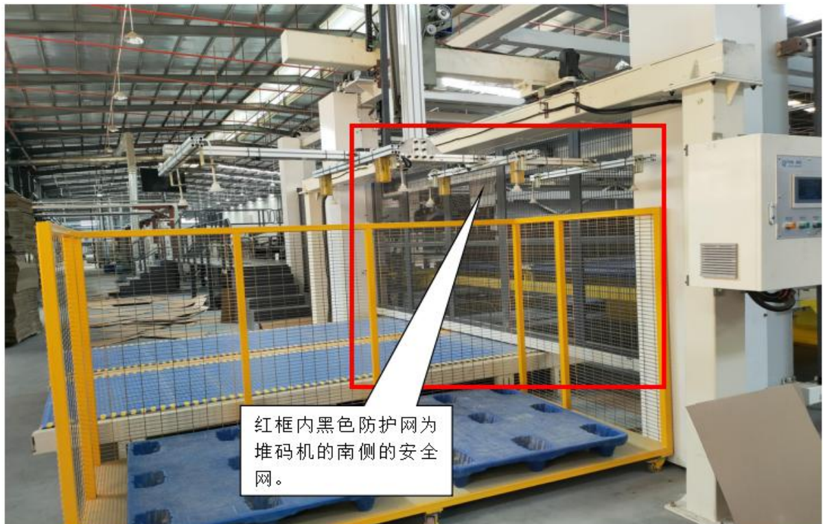
图 4：堆码机安全措施
