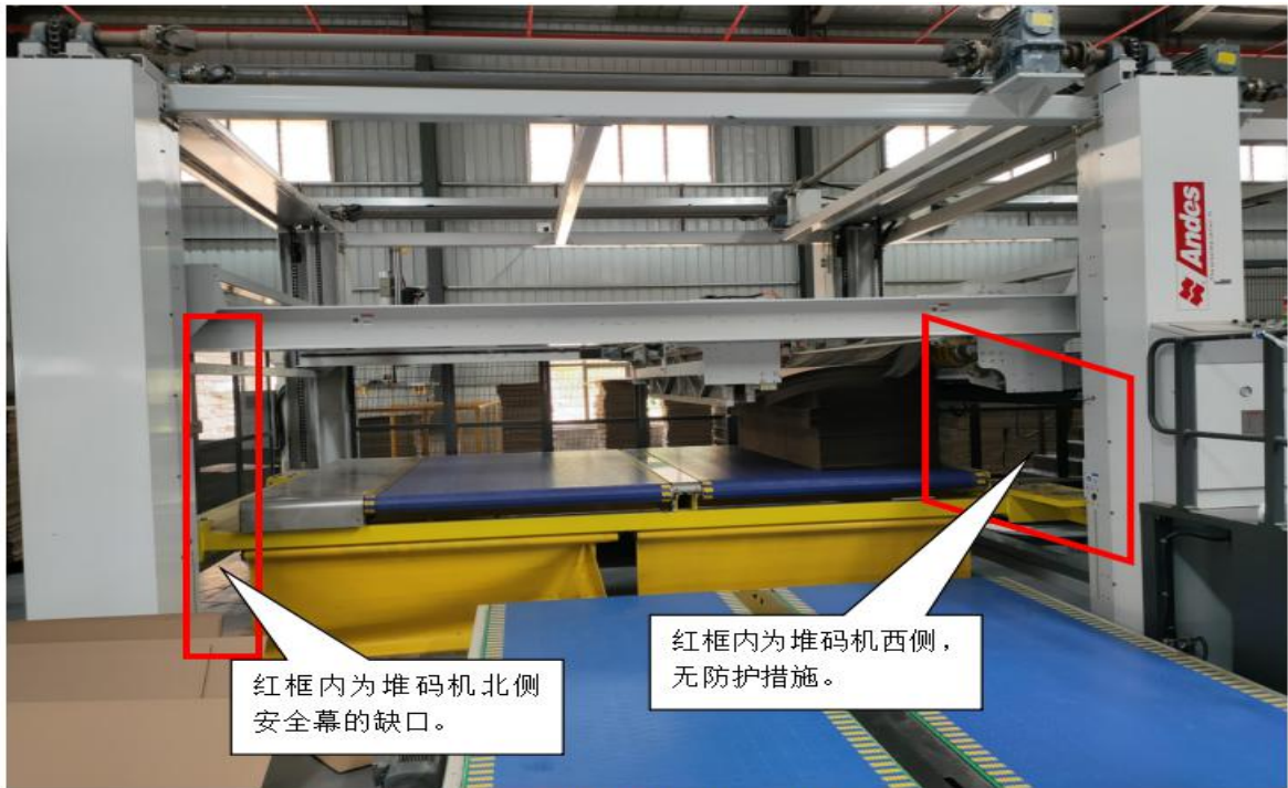
图 5：堆码机西侧无防护措施
