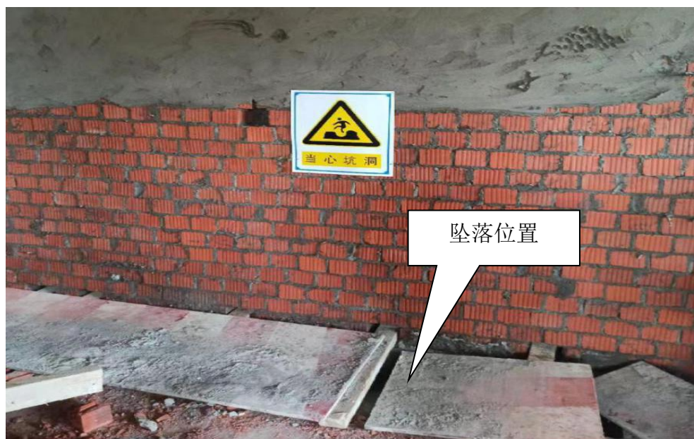
图 2 五楼排风井洞口照片
