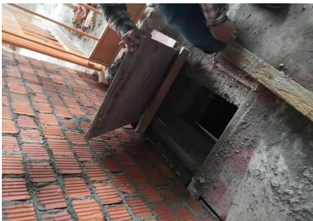
图 4 五楼排风井防护木板照片
