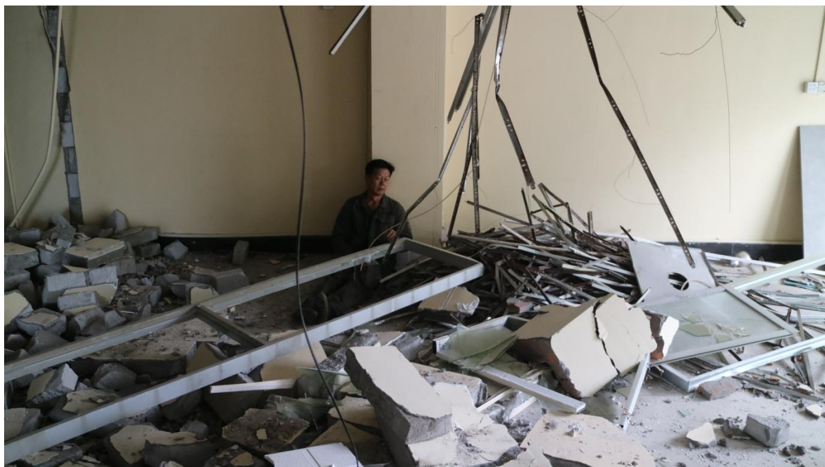
图1 杨年银模拟事故发生后的现场情况
