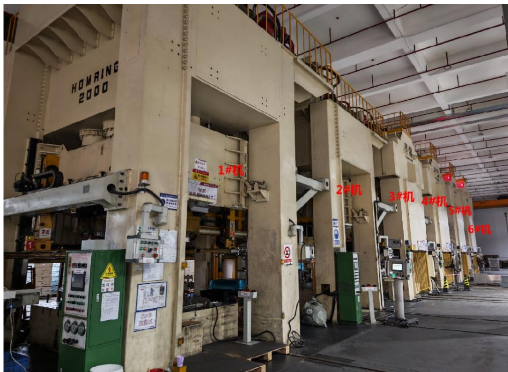
图 2 冲压线现场图
