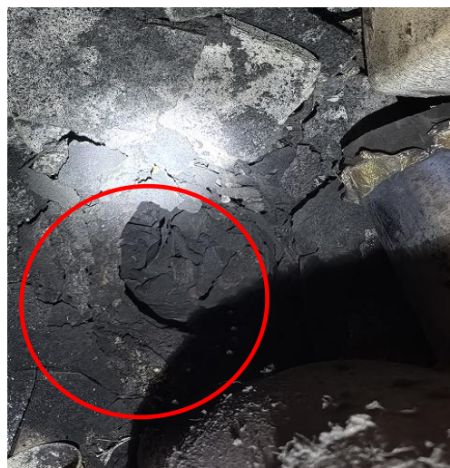
图 9 排烟管道炭黑积渣堵塞
