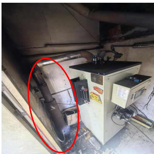
图 8 锅炉废气接入公共排水立管
