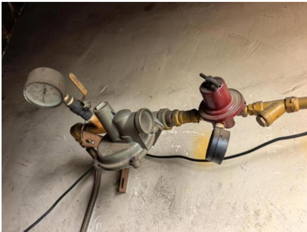
图 7 调压稳压装置现场图
