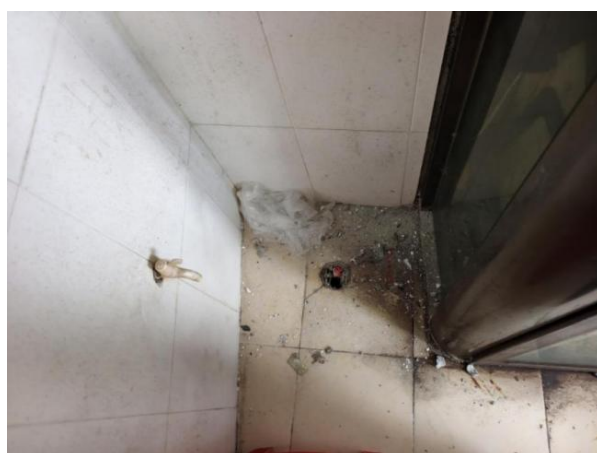
图15 窗口旁边排水口情况
