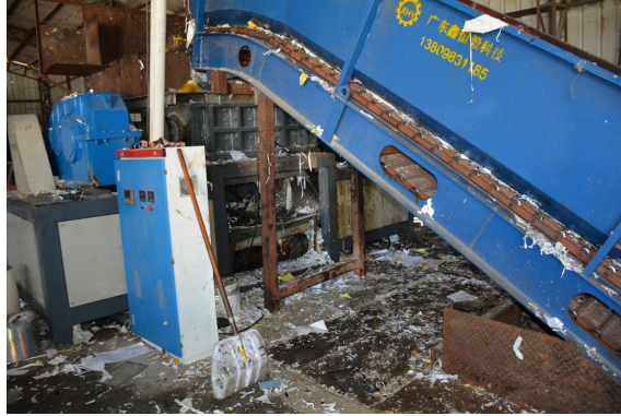
图11 撕碎机现场照片
