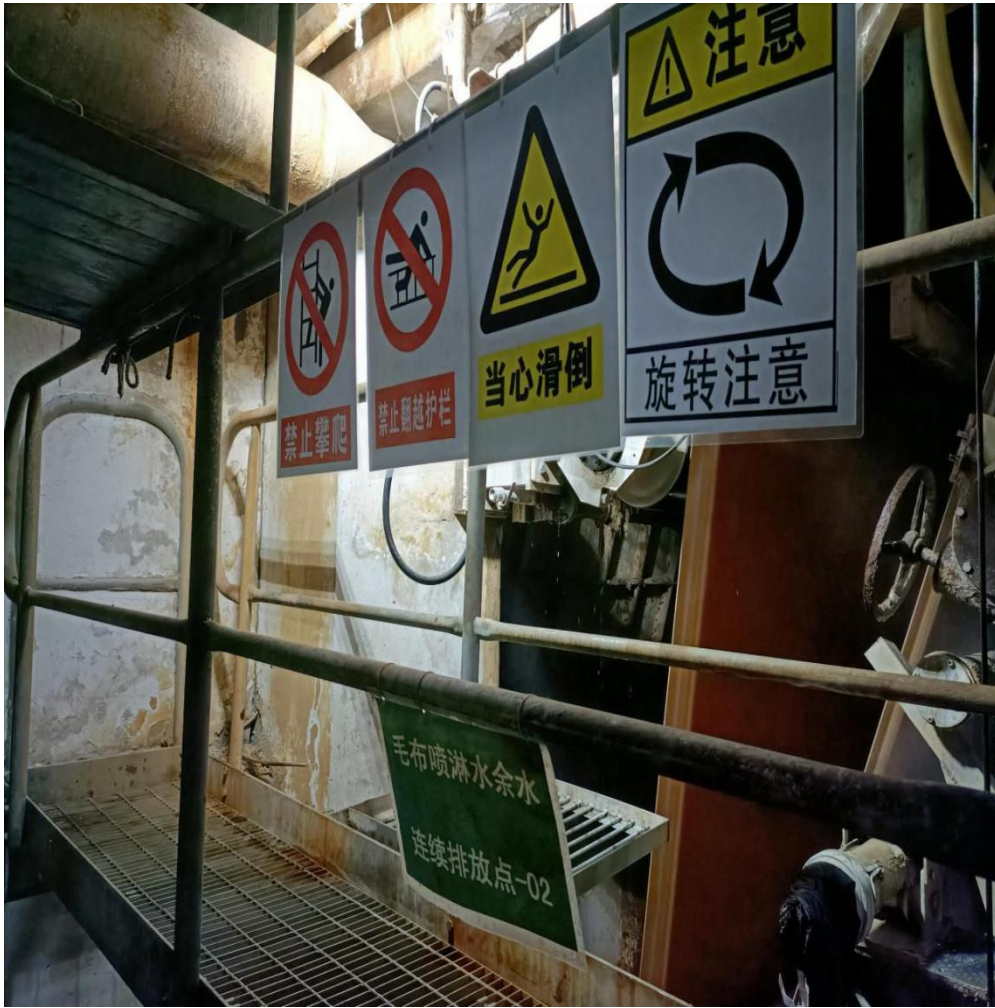
图 4 巡检平台张贴的安全警示标志
