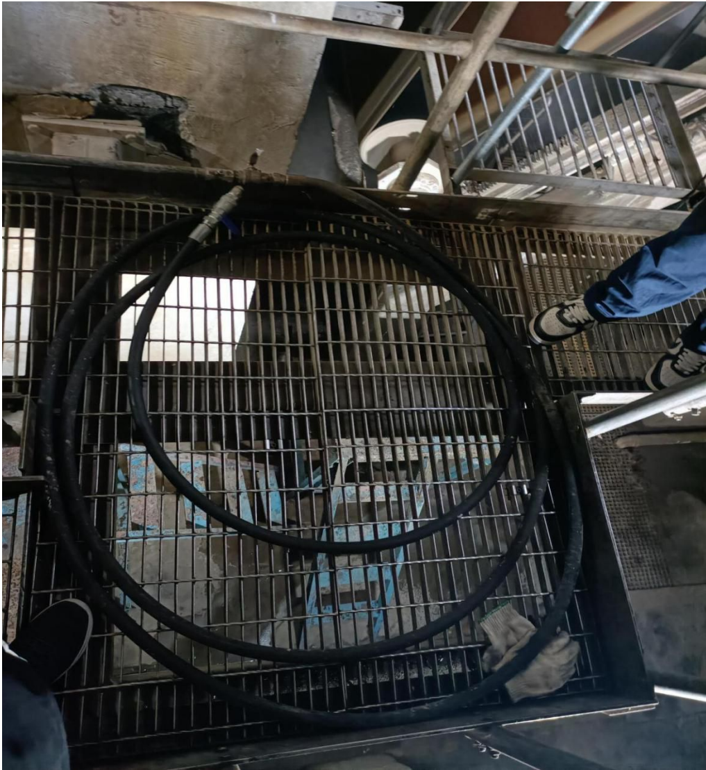
图5 巡检平台配置冲洗所用的水管
