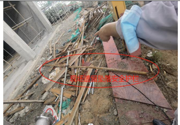
图 5 现场遗留坠落安全护栏
