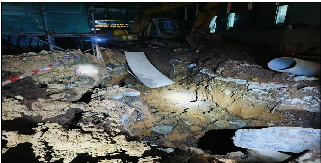
图 2 事故发生后的沟槽情况
