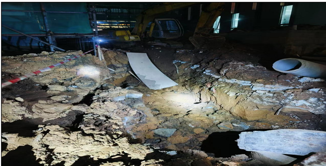
图 2 事故发生后的沟槽情况
