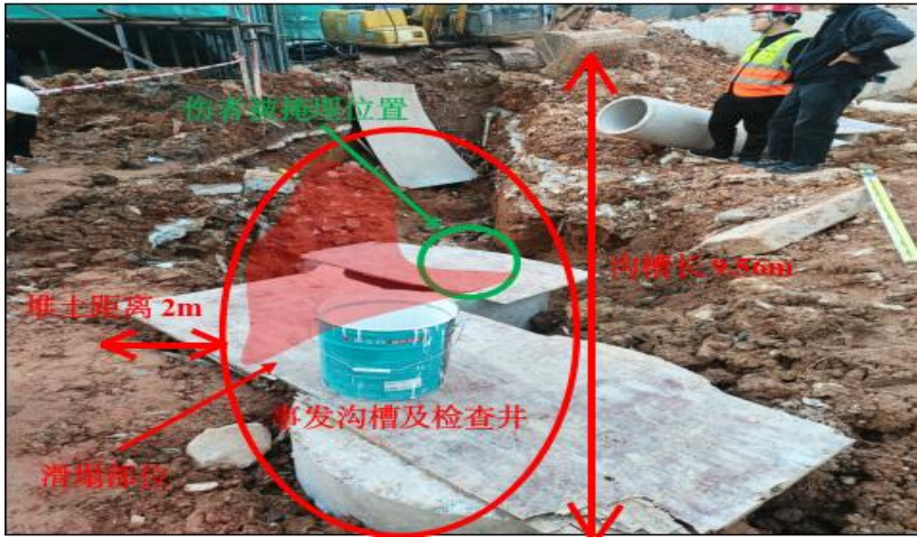
图 5 事发沟槽滑塌部位及人员掩埋位置示意图
