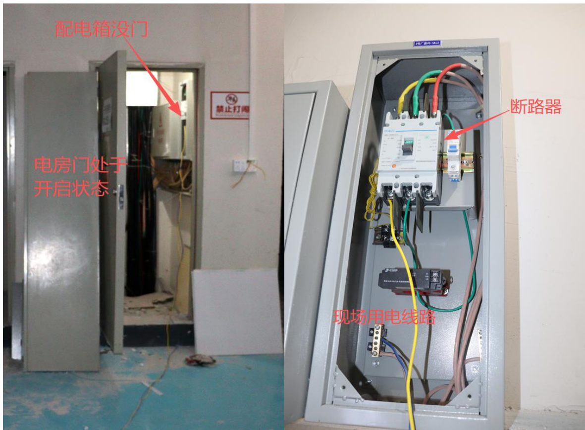
图 5 配电室及配电箱图片
