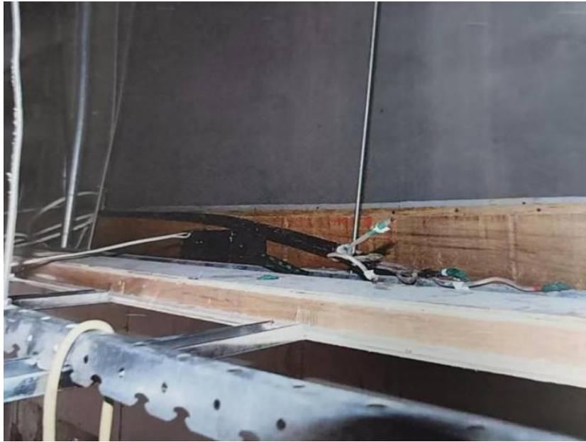
图5 天花板上有一组5芯电缆线
