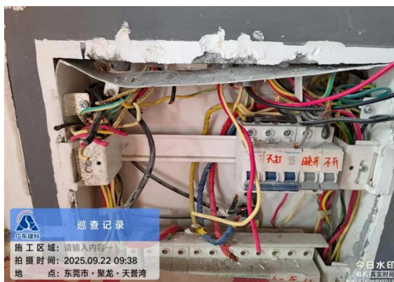
图2 入户配电箱总开关的漏电保护器被拆除
