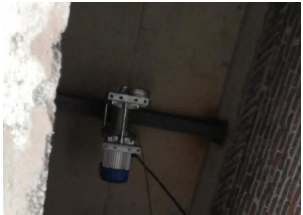
图 14 电动提升机吊挂在电梯井道顶部
