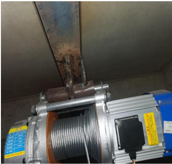
图 7 涉事设备的电动提升机（事发现场拍摄）
