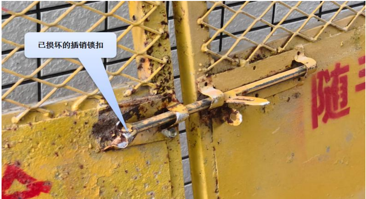
图 7 原 18 层左笼楼层插销锁扣（锁扣明显破损，已无法正常使用）
