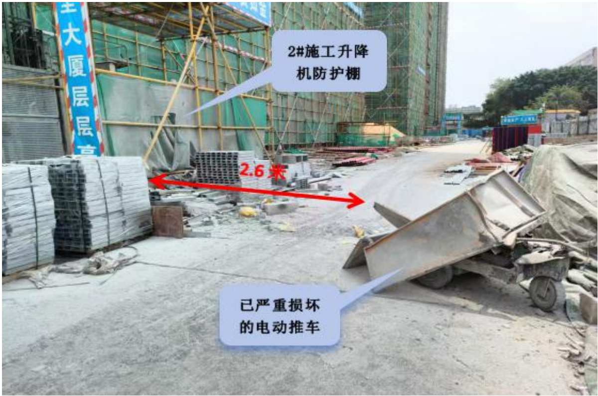
图3 电动斗车严重损坏现场图
