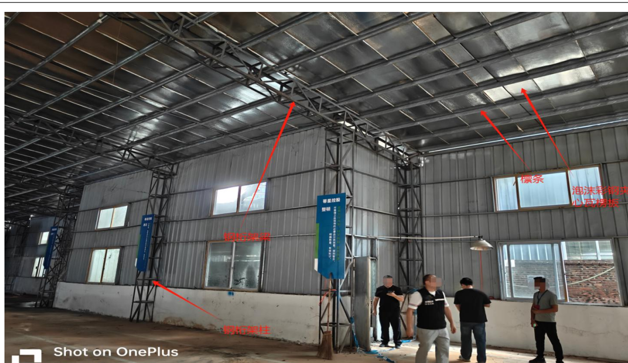
图 5 涉事钢结构屋面结构情况图
