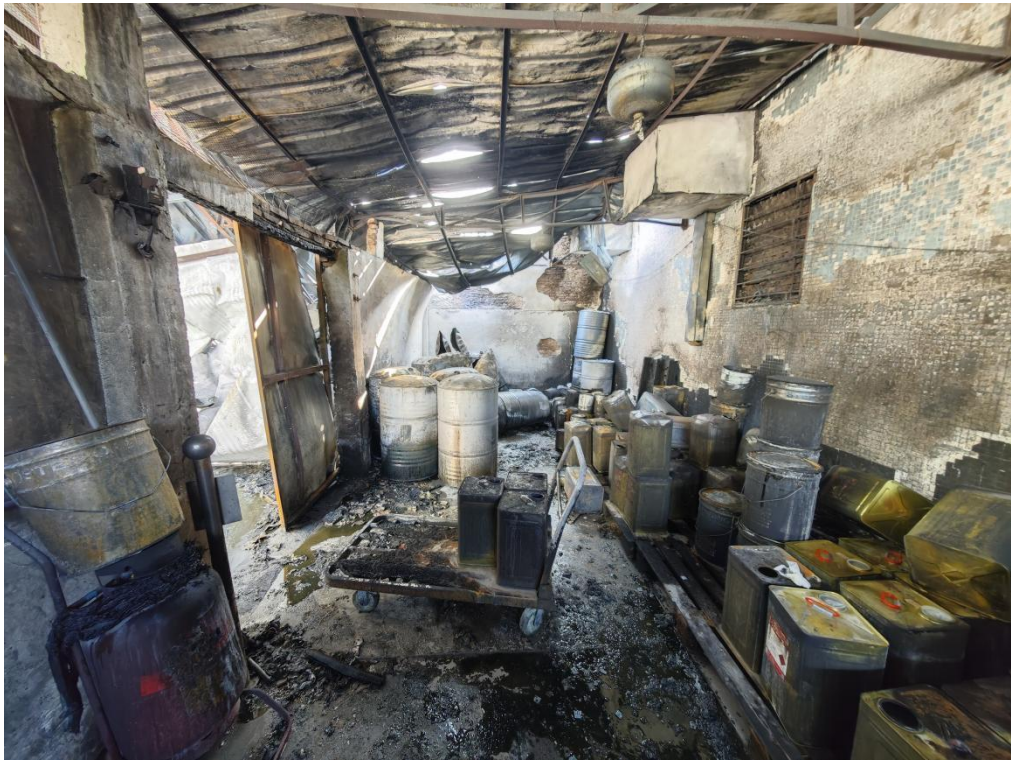
图3 事故危险化学品仓库现场图
