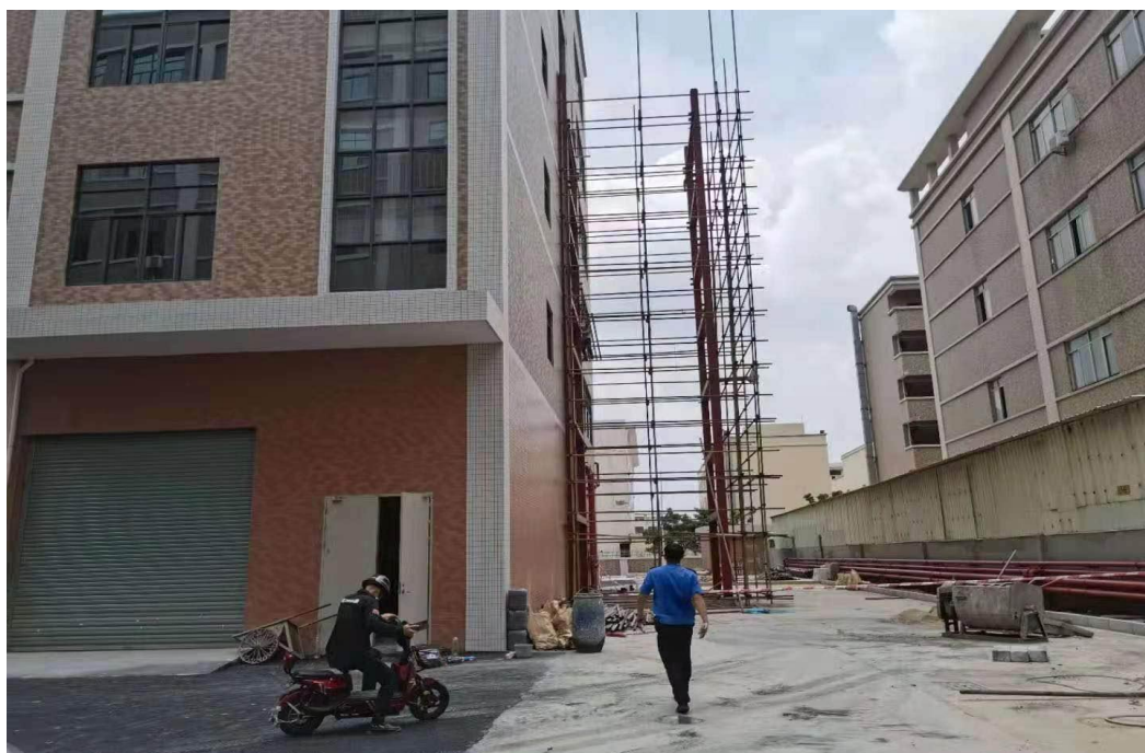
图 4.2021 年 6 月 24 日，川亿项目 3 号厂房存在未取得施工 许可擅自加建室外货梯行为
