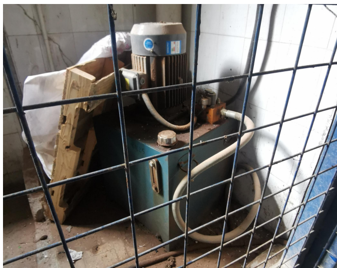
图 6 液压驱动主机安放在靠外墙的一角
