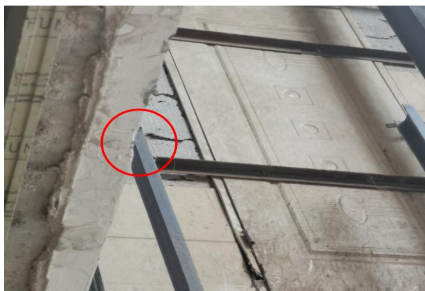
图 12 涉事搬运车碰撞四楼横梁留下的痕迹
