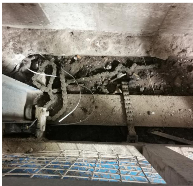
图 9 断裂的链条跌落在地面
