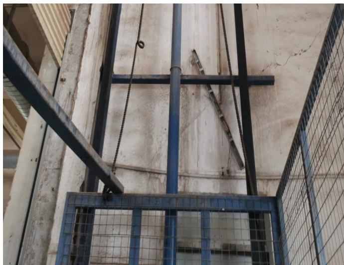
图 8 左侧两条悬挂链条断裂情况
