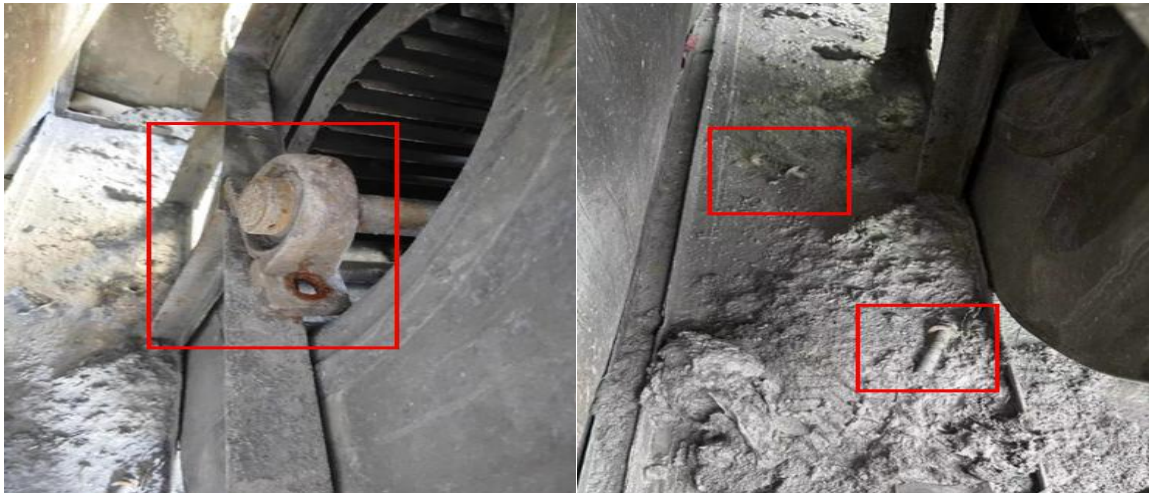
图 8 轴承座固定螺栓松脱掉落
