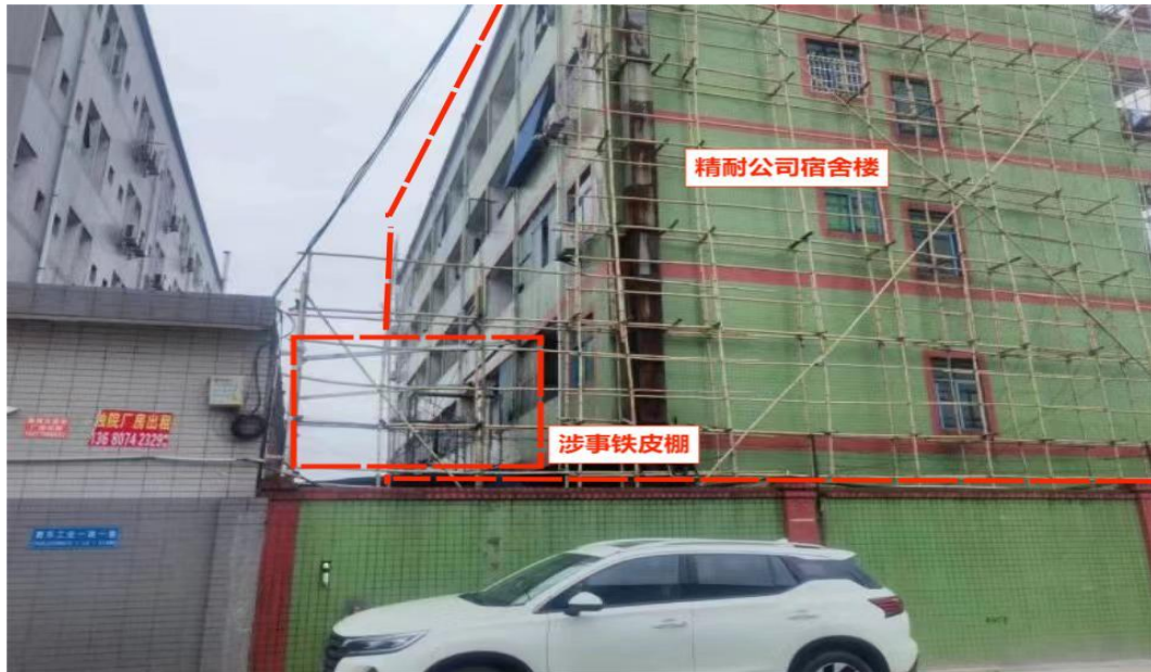
图 1 事故现场外照片
