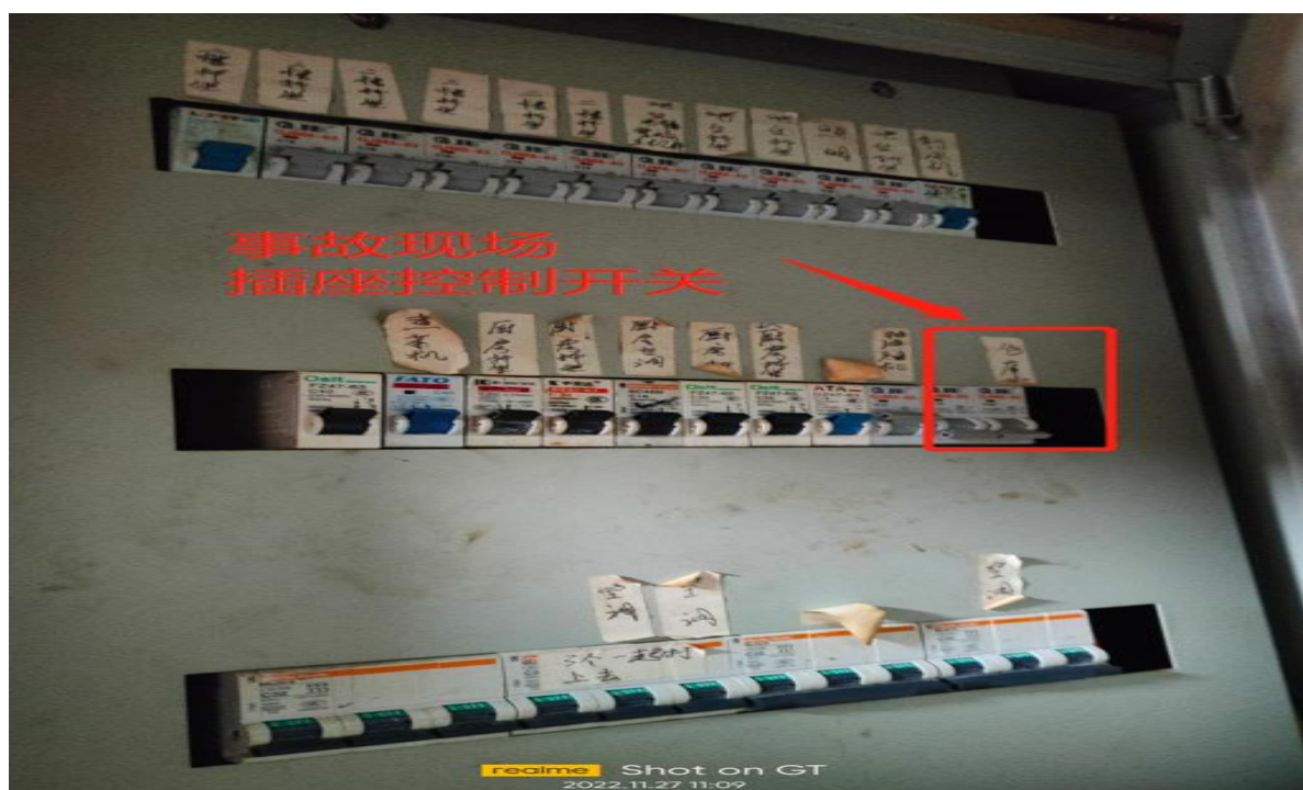
图 9 事故电源插座控制开关配电箱
